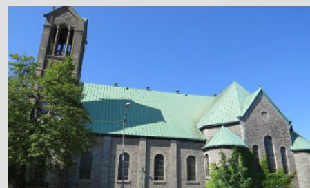
Mur de droite Photo : Bergeron Gagnon inc.
